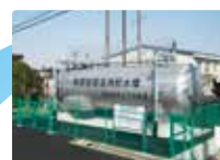
飲料水兼用耐震性貯水槽
