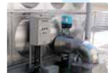
緊急遮断弁システム
